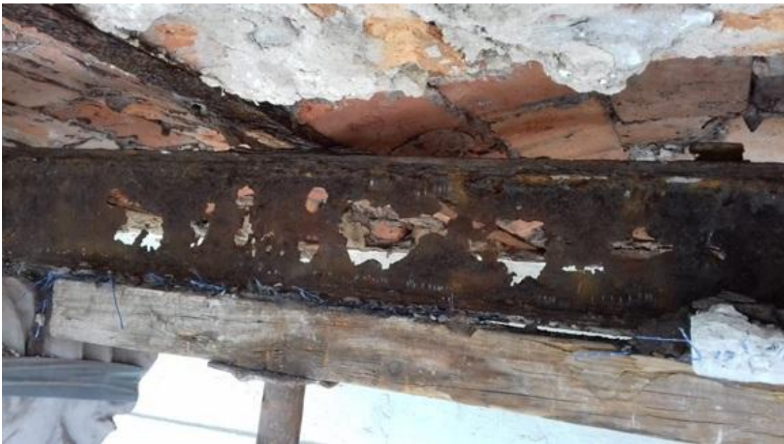
Figura 1. Corrosión en estructura de puente
